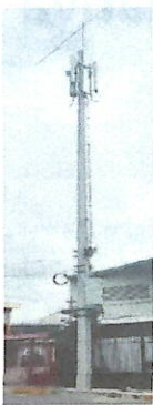
Postes de telecomunicaciones
