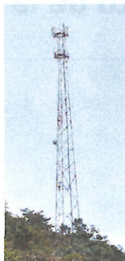
Torres de telecomunicaciones
